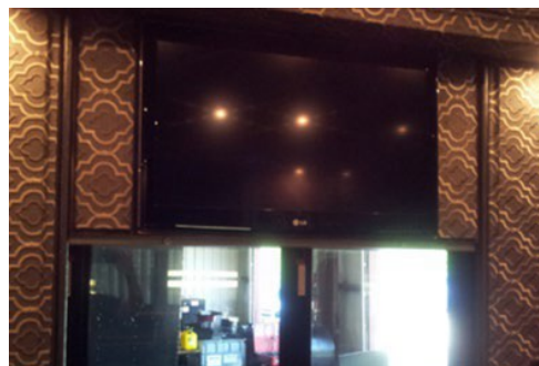
L'installation de téléviseurs et les panneaux ne parviennent pas à laisser l'accès aux poignées ou à suffisamment d'espace pour que la fenêtre sorte de son cadre. Cette sortie ne s'ouvrira pas.
